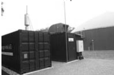
Ко-генератор в контейнере.
