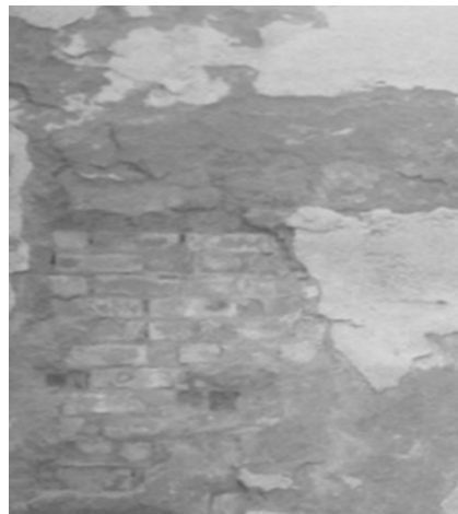
Рис. 2. Разрушение фундамента кладки
