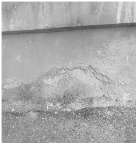
Рис. 1. Отслоение кусков штукатурки
